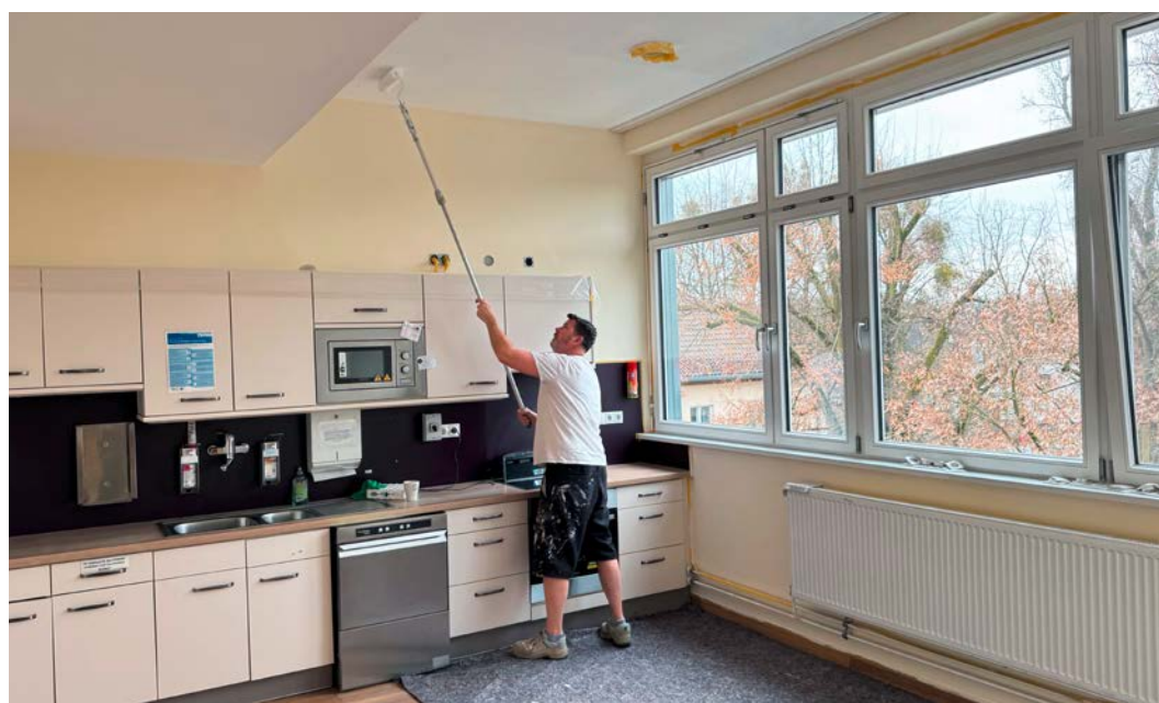
Zur Vorbereitung auf den Sommer hat die Berliner Christophorus Pflege einen Koch- und Essbereich mit großer Fensterfront zum Süden mit der Klimabeschichtung ausgestattet.
